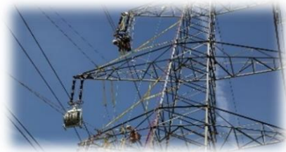
(Abbildung 12: Stromversorgung im Inntal)
